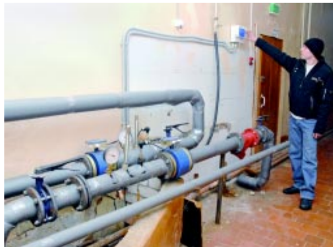
Теплосчётчик в школе №1.
