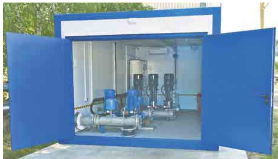
Новая станция водооборотного снабжения АПЗ.
